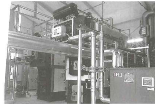
南会津高原リゾート熱電供給施設
