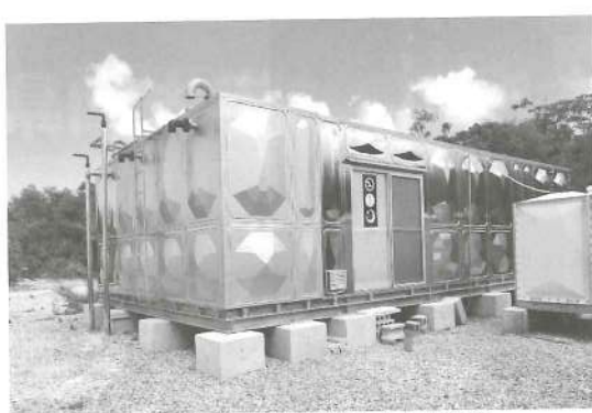
「星のや竹富島」に導入された設備
