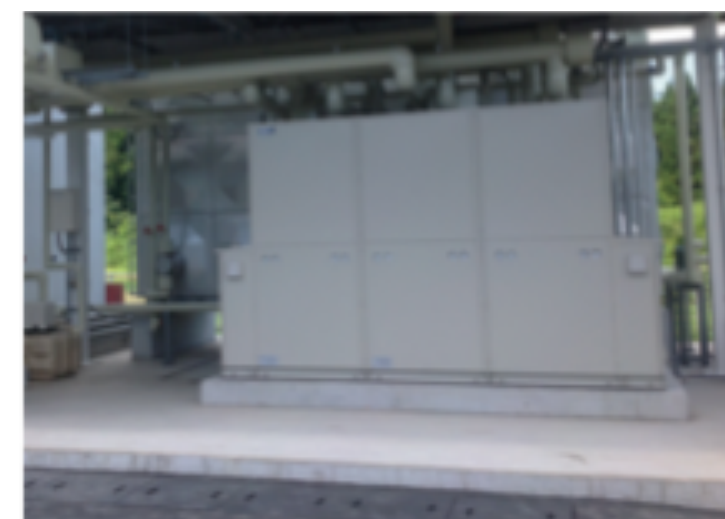
地中熱ヒートポンプ
